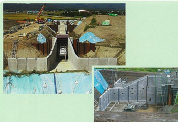
施主 北海道開発局 石狩川建設部 岩見沢河川事務所 工事名 札比内5号樋門工事 B×H 1500×2000
