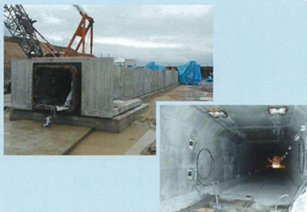
施主 九州地方整備局 筑後川河川事務所 工事名 出来島排水樋管改築工事 B×H 1500×1250
