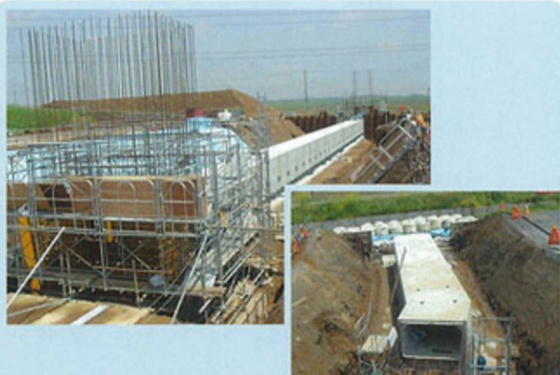
施主 国土交通省 関東地方整備局 利根川上流河川事務所 工事名 川端排水樋管改築工事 B×H 1550×1550
