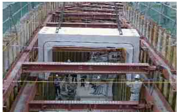
2分割SJ-BOX 3400×3000 (国土交通省浪速国道事務所)
