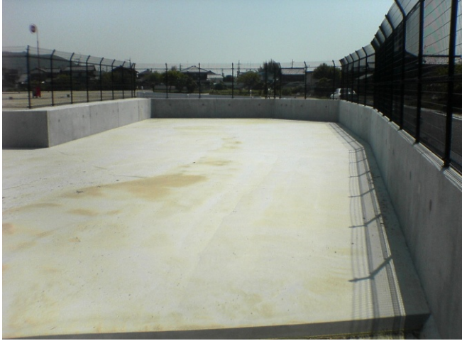
宅地造成に伴う雨水流出抑制のための雨水調整池
