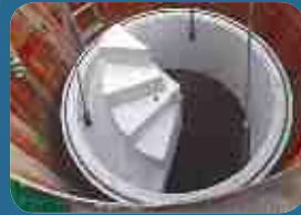
落差マンホール
