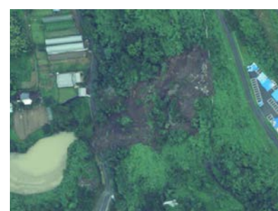
ボタ山わんぱく公園の法面崩壊 （佐賀県大町町）
