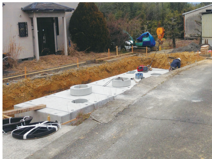
狭隘地での設置例
