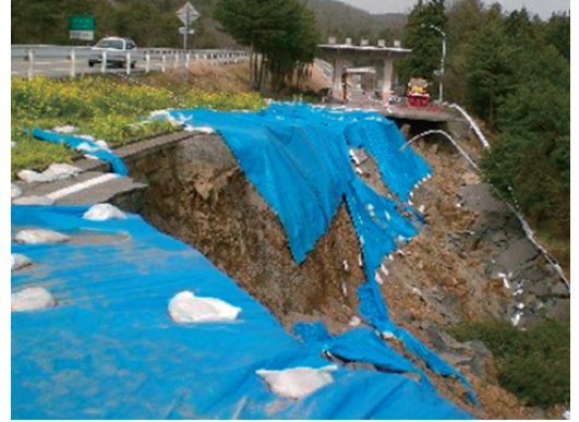
盛土の被災状況
