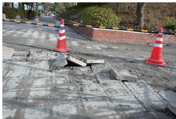
▲地震による液状化現象
