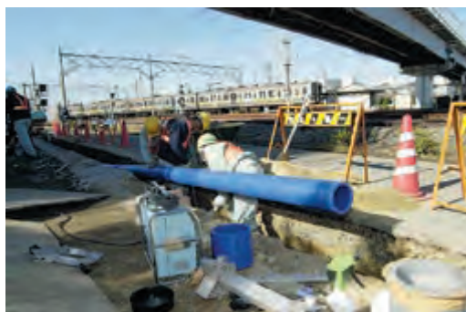
軌道付近(電食対策)
